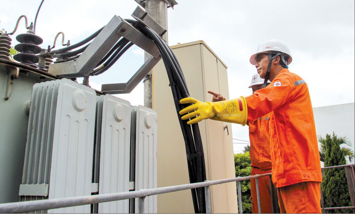
Công nhân Điện lực Tiên Hải kiểm tra hoạt động của trạm biến áp.
