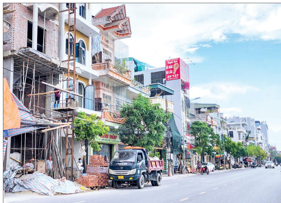
Công trình xây dựng nhà ở trên địa bàn phường Kỳ Bá tập kết vật liệu xây dựng chưa bảo đảm quy định.
