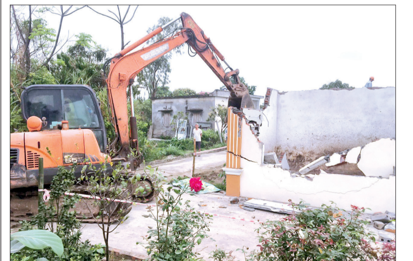
UBND xã Song An huy động lực lượng tiến hành cưỡng chế, thu dỡ toàn bộ công trình xây dựng vi phạm của gia đình ông Đoàn.
