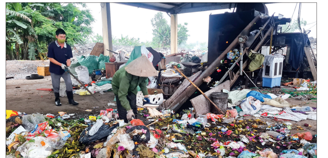
Lò đốt rác xã Đông Xuân (Đông Hưng) sau 10 năm hoạt động đã xuống cấp.
