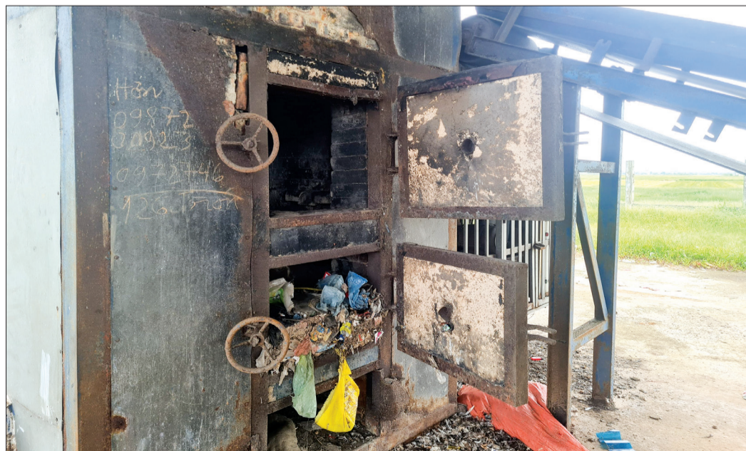
Lò đốt rác thải sinh hoạt xã Minh Tân (Kiến Xương) hư hỏng, dừng hoạt động.
