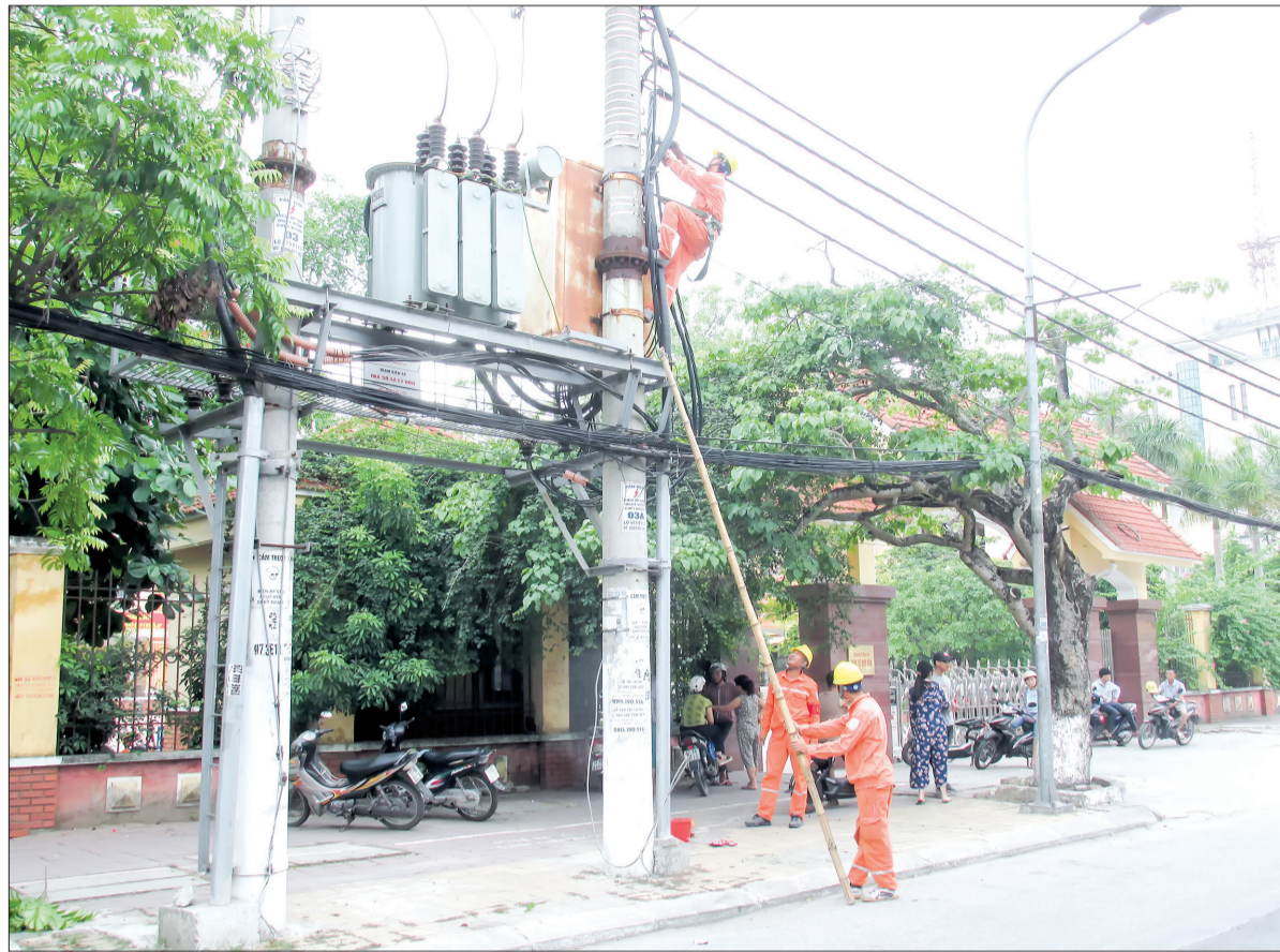
Công nhân Điện lực thành phố kiểm tra trạm biến áp trước cổng Trường THPT Lê Quý Đôn.
