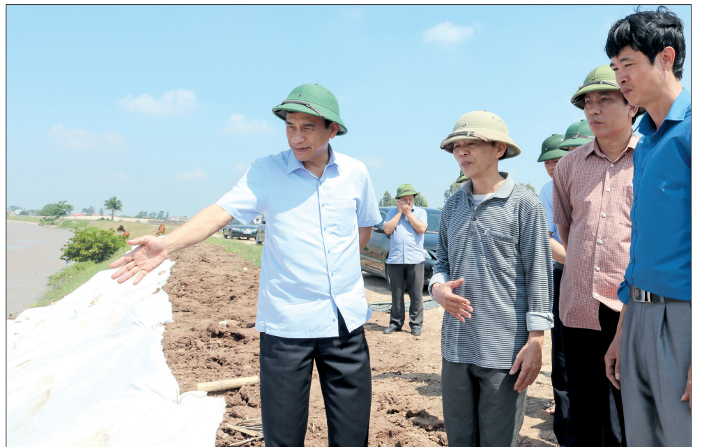
Đông chí Đặng Trọng Thăng, Phó Bí thư thường trực Tỉnh ủy, Chủ tịch UBND tỉnh chỉ đạo đơn vị thi công kè Thái Phúc (xã Thái Phúc, huyện Thái Thụy) khẩn trương có phương án bảo vệ phần công trình đã hoàn thành và giữ vững phần kè chưa thi công.
