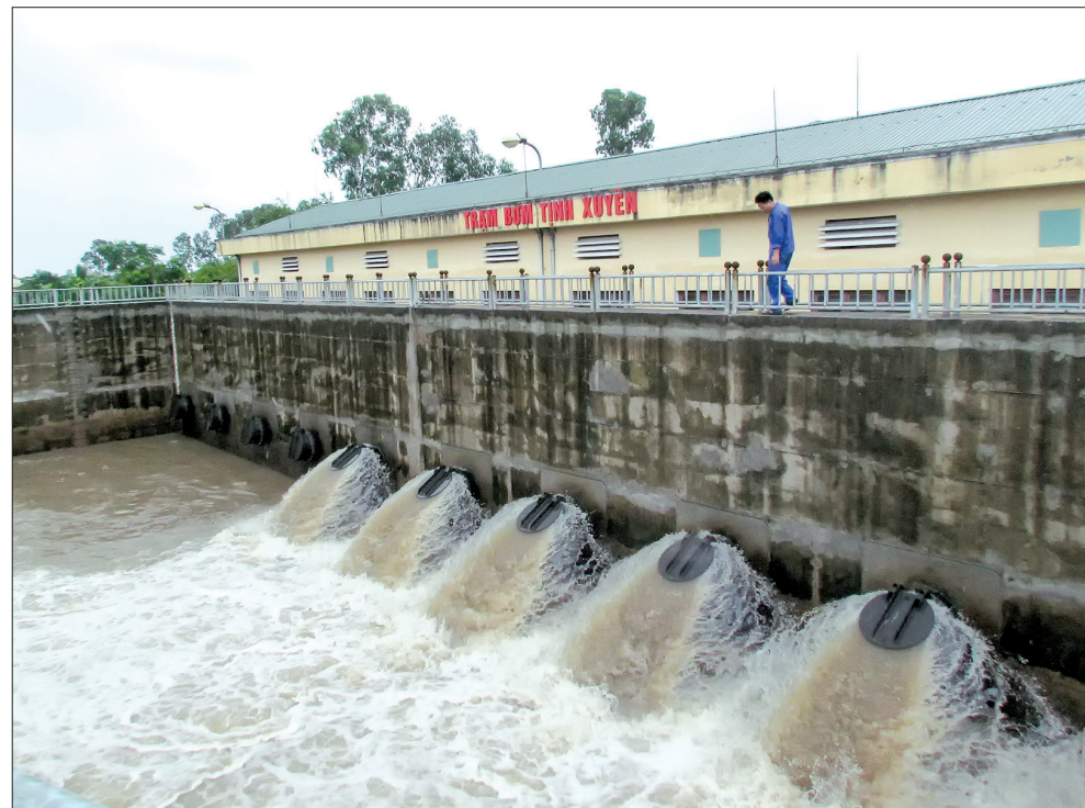
Trạm bơm Tĩnh Xuyên (Hưng Hà) sẵn sàng vận hành tiêu thoát nước khi có mưa lớn xảy ra.
