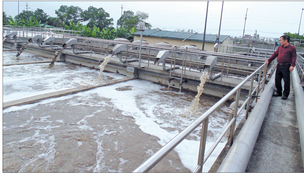
Hệ thống xử lý nước thải của khu công nghiệp Nguyễn Đức Cảnh, Phúc Khánh.
