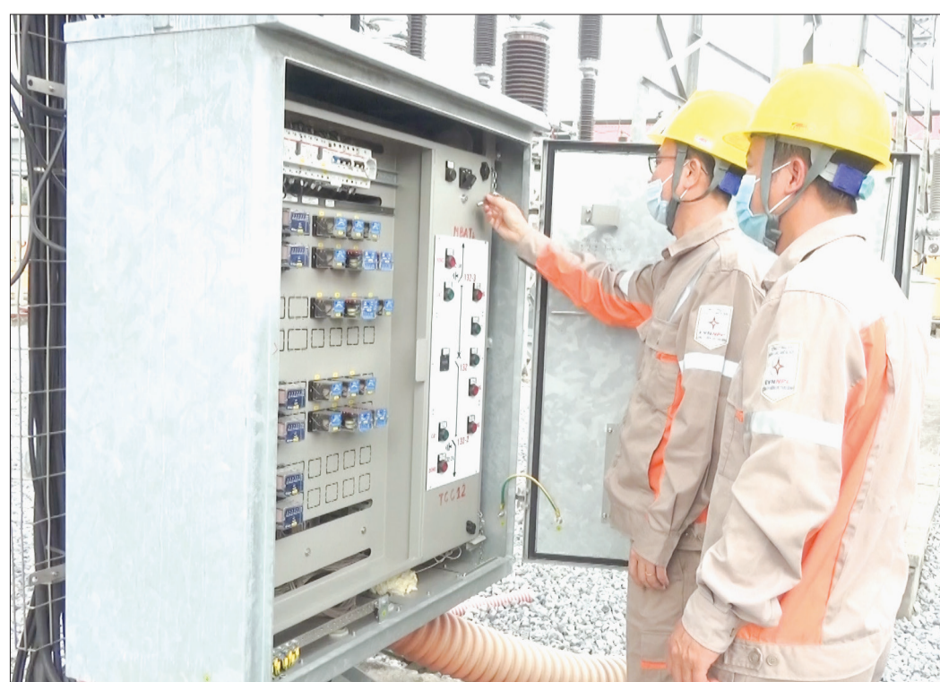
Công nhân Công ty Điện lực Thái Bình kiểm tra hoạt động của máy biến áp 110kV.
