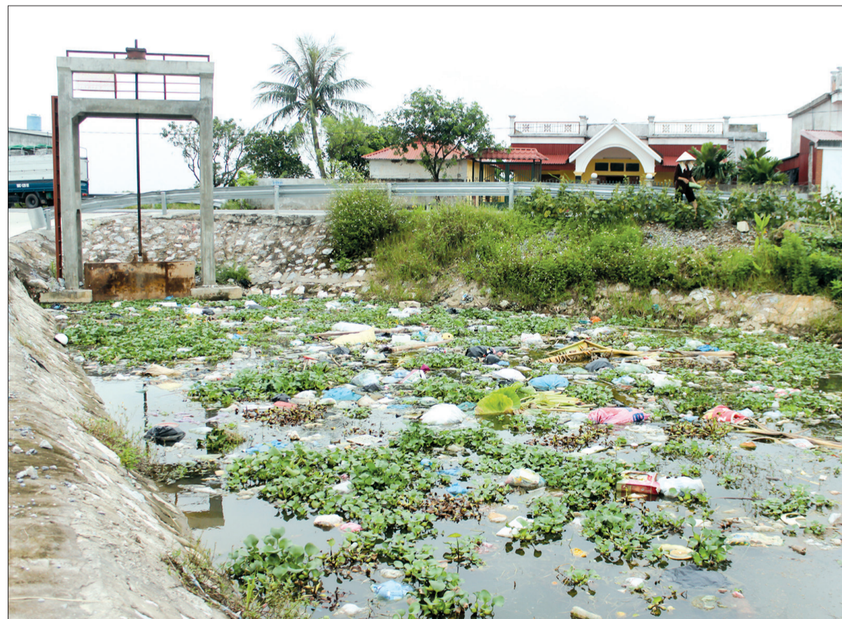
Rác thải tràn ngập một đoạn kênh mương thuộc địa bàn xã Thái Giang.
