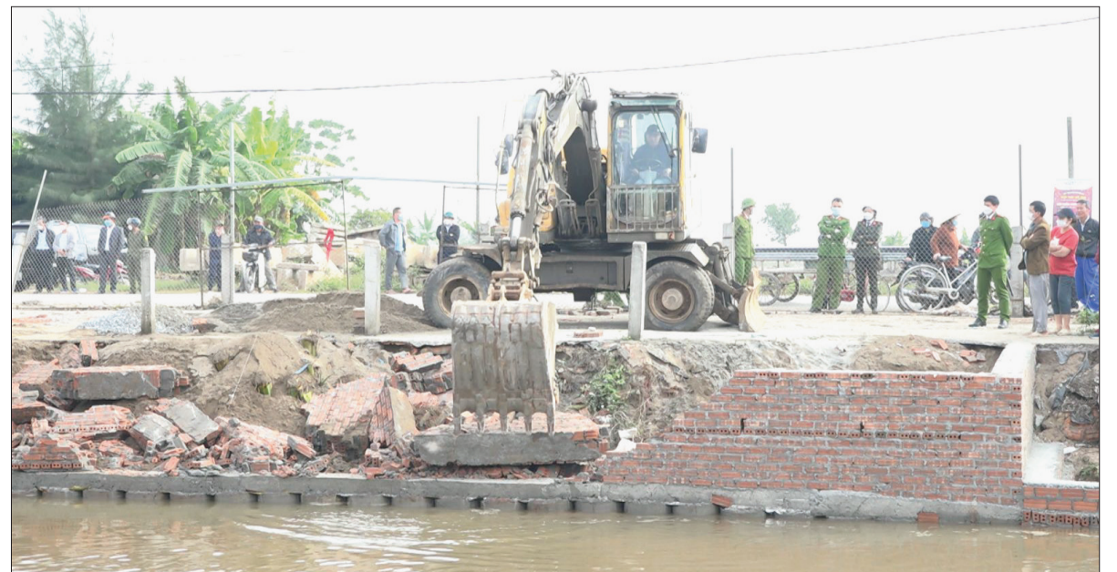
Ngành chức năng huyện Tiền Hải tổ chức tháo dỡ công trình vi phạm hành lang sông Thủ Chính, đoạn qua địa bàn xã Nam Trung.
