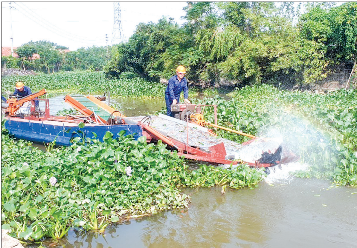
Công nhân Xí nghiệp Khai thác công trình thủy lợi huyện Tiên Hải thu vớt bèo bồng trên kênh thủy lợi.
