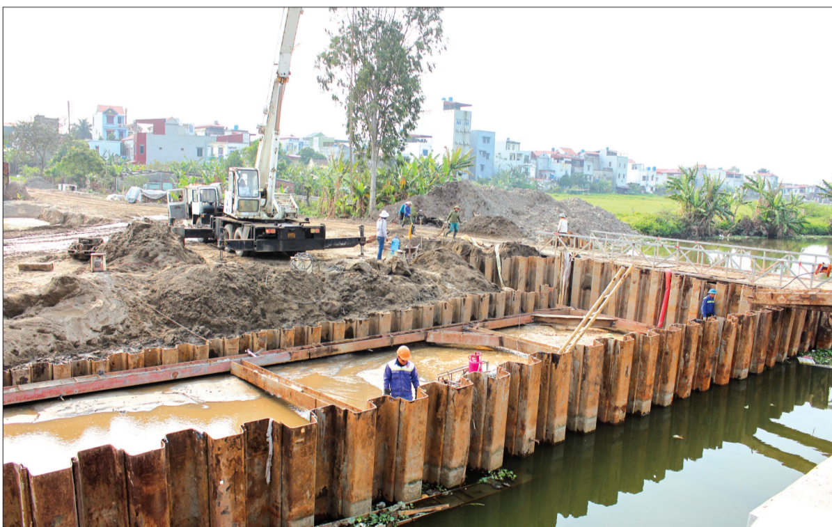
Thi công tuyến đường quy hoạch số 5 từ đê sông Diêm Hộ đến đường quy hoạch số 2, huyện Thái Thụy.
