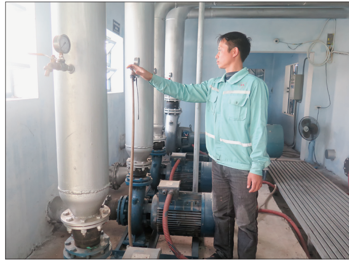
Công nhân vận hành nhà máy nước Thủy Long.
