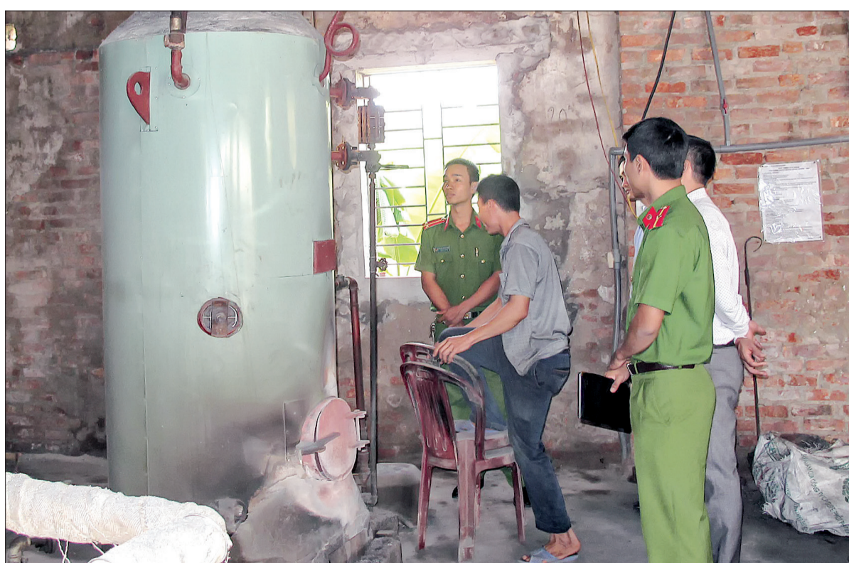
Công an huyện Thái Thụy phối hợp với các ngành chức năng kiểm tra công tác phòng, chống cháy, nổ tại cơ sở sản xuất nước mắm truyền thống trên địa bàn huyện.
