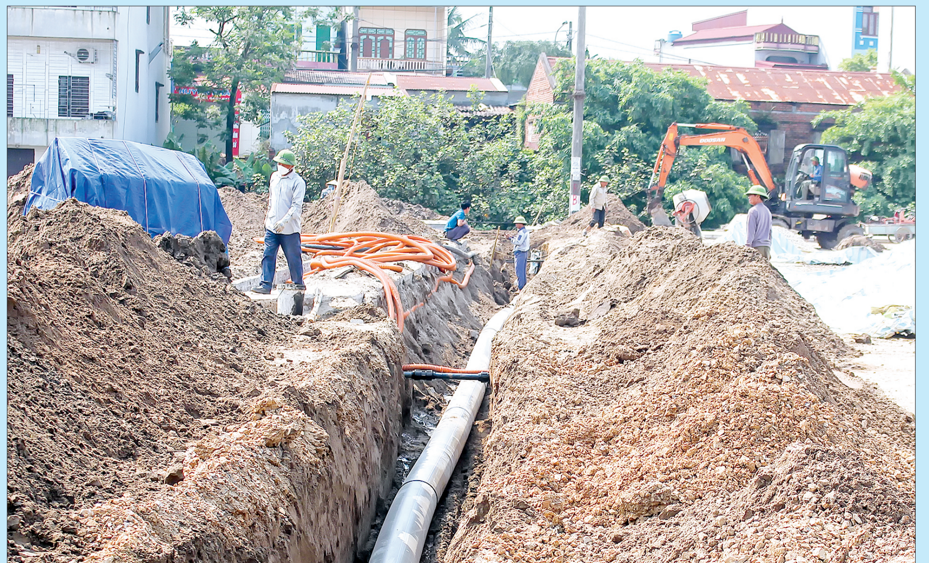
Thi công hệ thống đường ống nước thải tại dự án hạ tầng khu dân cư đô thị OBT-8B, thị trấn Diêm Điền (Thái Thụy).
