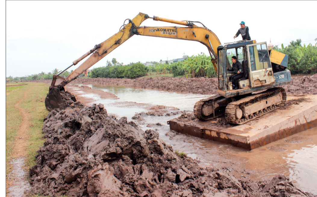
Xí nghiệp Khai thác công trình thủy lợi huyện Tiền Hải nạo vét sông trục, sông dẫn phục vụ sản xuất vụ xuân.
