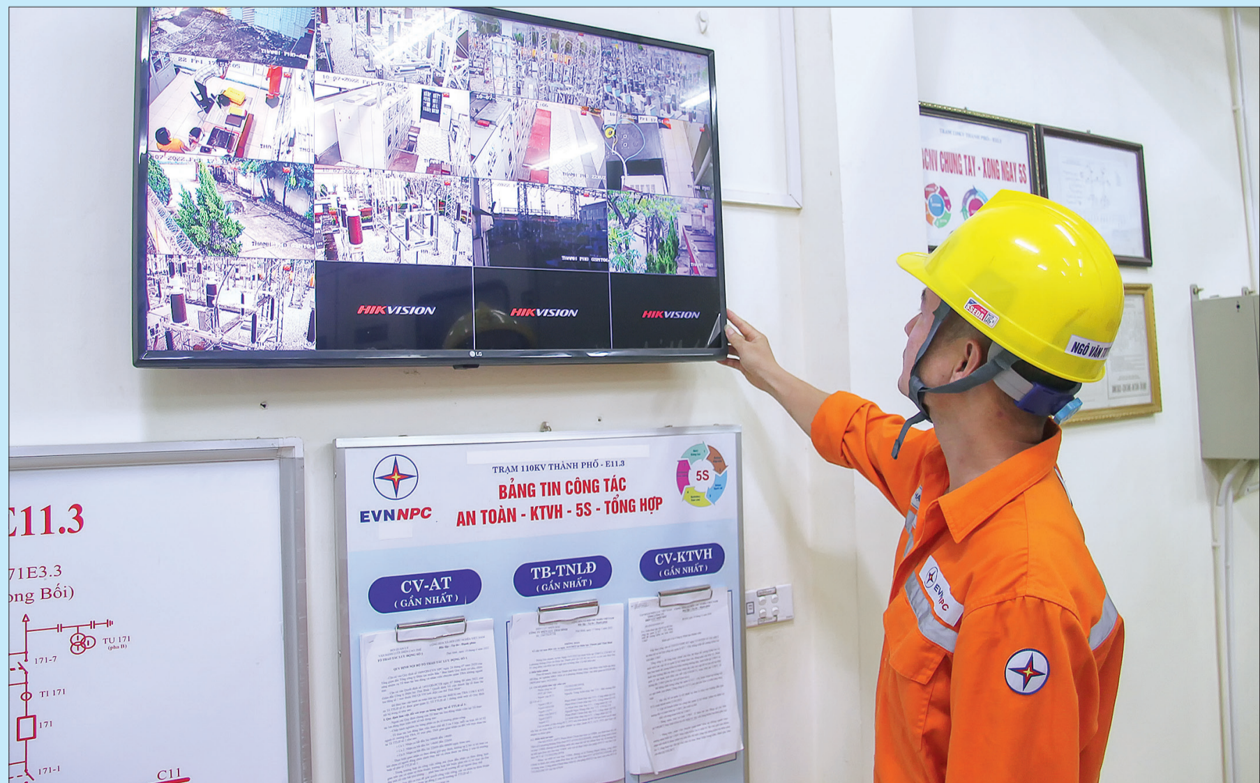
Công nhân Công ty Điện lực Thái Bình theo dõi hoạt động của trạm biến áp qua hệ thống camera.
