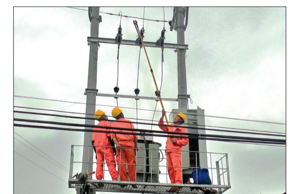
Công nhân Điện lực Thái Thụy kiểm tra máy biến áp.
