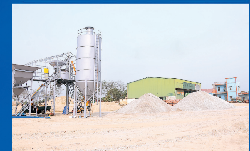
Trạm trộn bê tông không phép và nhà kiên cố 2 - 3 tầng mọc lên ngay trên hành lang đê thuộc địa phận thôn Thái Hạc, xã Việt Thuận (Vũ Thư).
