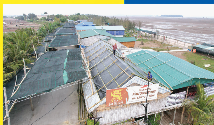
Nhà hàng, quán ăn xây dựng trái phép trên mái dè biển số 6 thuộc địa phận xã Đông Minh (Tiền Hải).
