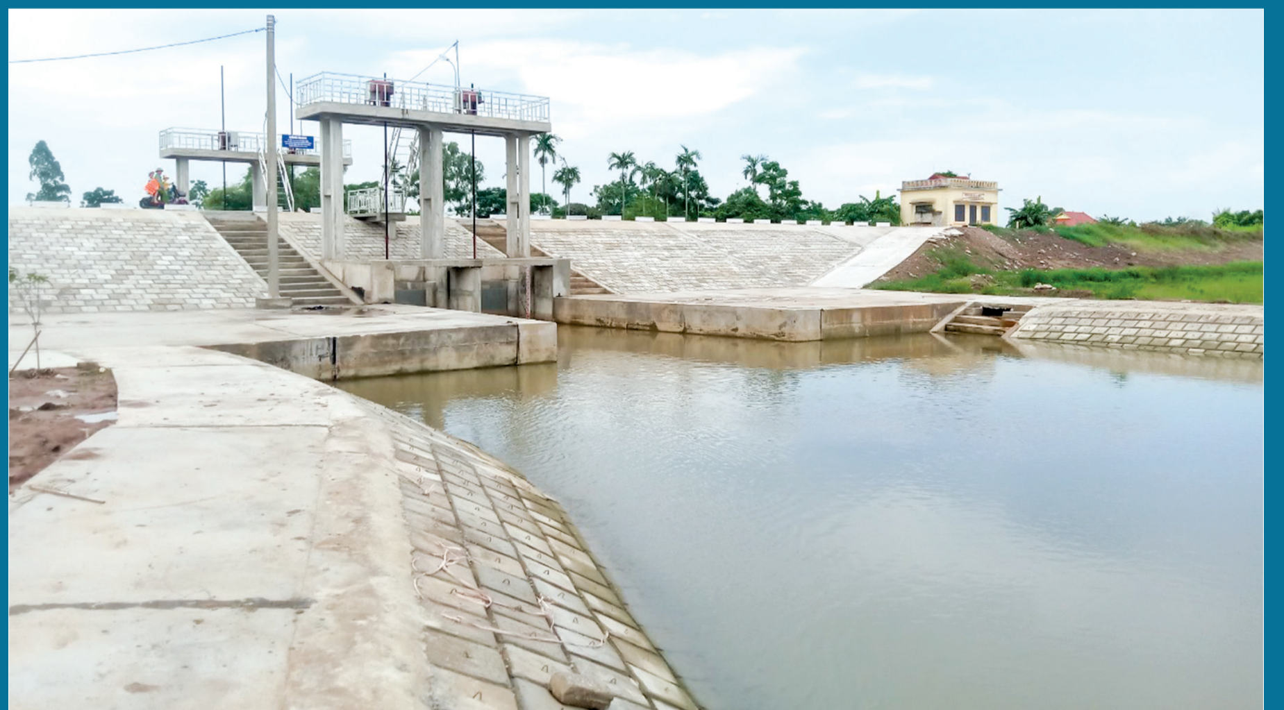
Công trình cống Mang (Quỳnh Phú) hoàn thành, bảo đảm an toàn phòng, chống thiên tai.
