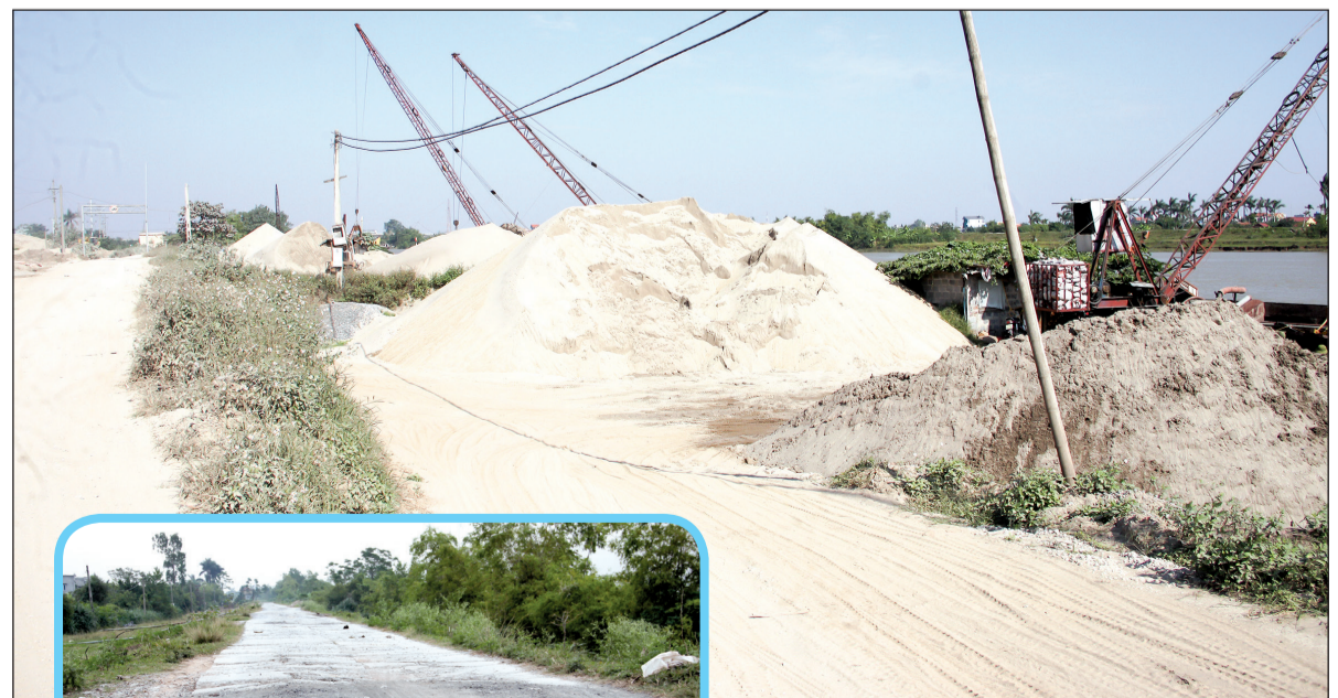
▲ Bãi tập kết vật liệu xây dựng ven đê Trà Lý đoạn qua địa phận phường Tiến Phong, thành phố Thái Bình.
