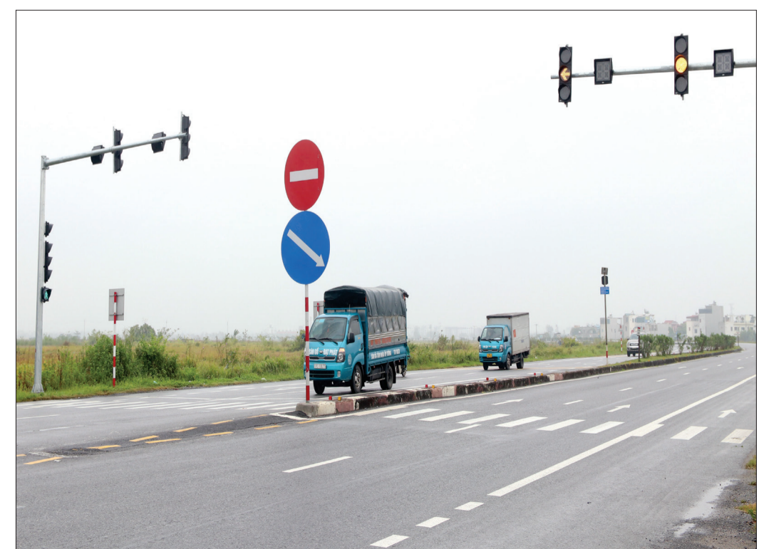
Ngã tư giao quốc lộ 10 đoạn Km89+500 với đường trục xã Minh Quang (Vũ Thư) đã được lắp đặt hệ thống đèn tín hiệu giao thông.
