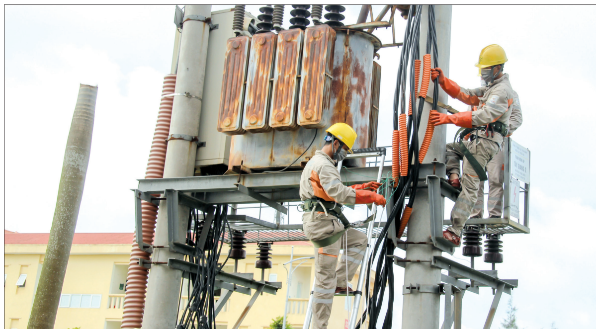
Công nhân Điện lực Tiên Hải kiểm tra, bảo dưỡng trạm biến áp, bảo đảm cấp điện ổn định, an toàn.
