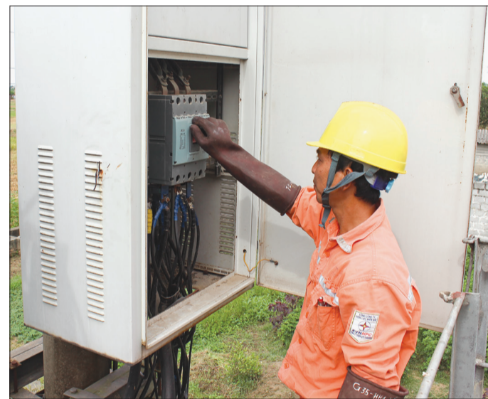
Công nhân Công ty Điện lực Thái Bình kiểm tra hoạt động của trạm biến áp, bảo đảm cung cấp điện ổn định, an toàn.
