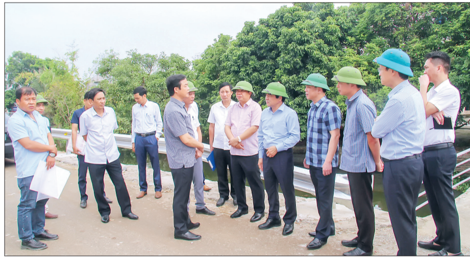
Các đồng chí lãnh đạo tỉnh kiểm tra tiến độ thi công tuyến đường từ thành phố Thái Bình qua cầu Tinh Xuyên, đoạn từ ĐT.453 đến thị trấn Hưng Hà.
