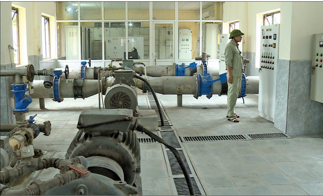
Khu trung tâm vận hành cung cấp nước sạch của Xí nghiệp nước thành phố Thái Bình.
