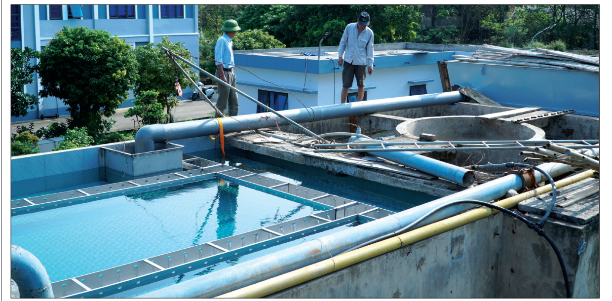
Xí nghiệp nước sạch Vũ Thư đang đẩy nhanh tiến độ cải tạo, nâng cấp công suất xử lý nước sạch từ 3.000m³ lên 6.000m³/ngày đêm.
