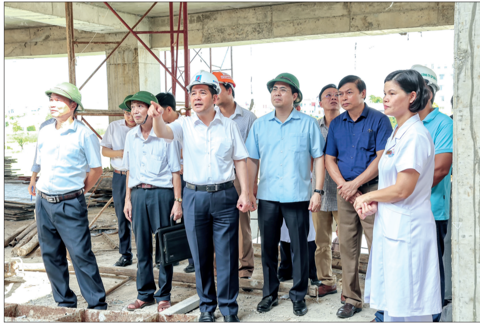
Đồng chí Nguyễn Hồng Diễn, Ủy viên Trung ương Đảng, Bí thư Tỉnh ủy, Chủ tịch HĐND tỉnh kiểm tra tiến độ thi công dự án nhà số 3, Khoa Cận lâm sàng, Nhà Nghiệp vụ kỹ thuật và Khoa truyền nhiễm, Bệnh viện Nhi Thái Bình.
