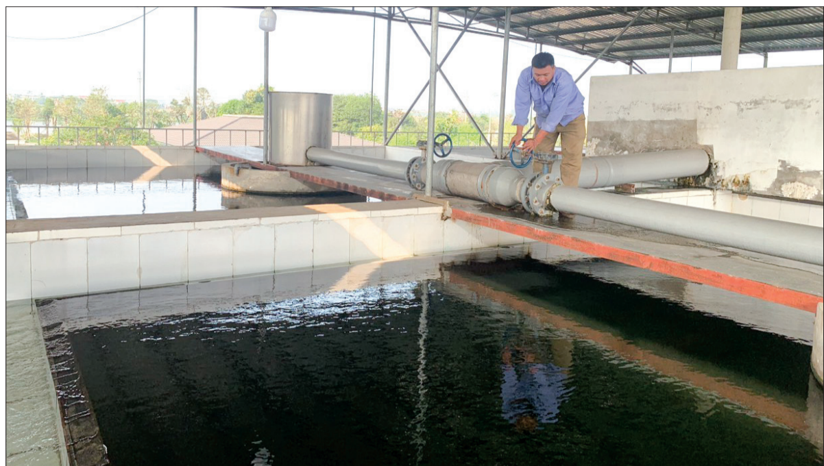
Công nhân nhà máy nước sạch Thái Dương kiểm tra hệ thống bể xử lý nước sạch.
