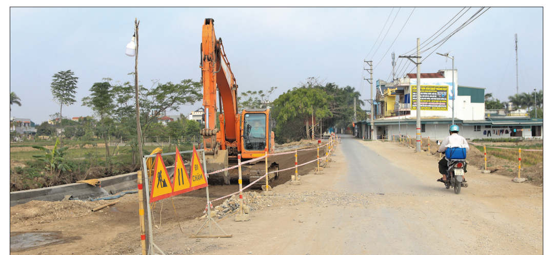
Đơn vị thi công lắp đặt hệ thống rào chắn, biển cảnh báo tại các nút giao với đường dân sinh tại dự án đường vành đai phía Nam thành phố Thái Bình.
