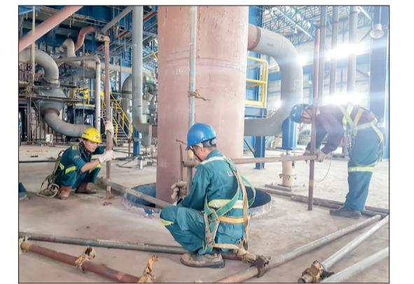
Lắp đặt thiết bị bên trong Nhà máy nhiệt điện Thái Bình 2.
