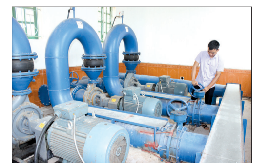
Công nhân nhà máy nước sạch xã Nam Chính (Tiền Hải) kiểm tra hệ thống bơm nước.
