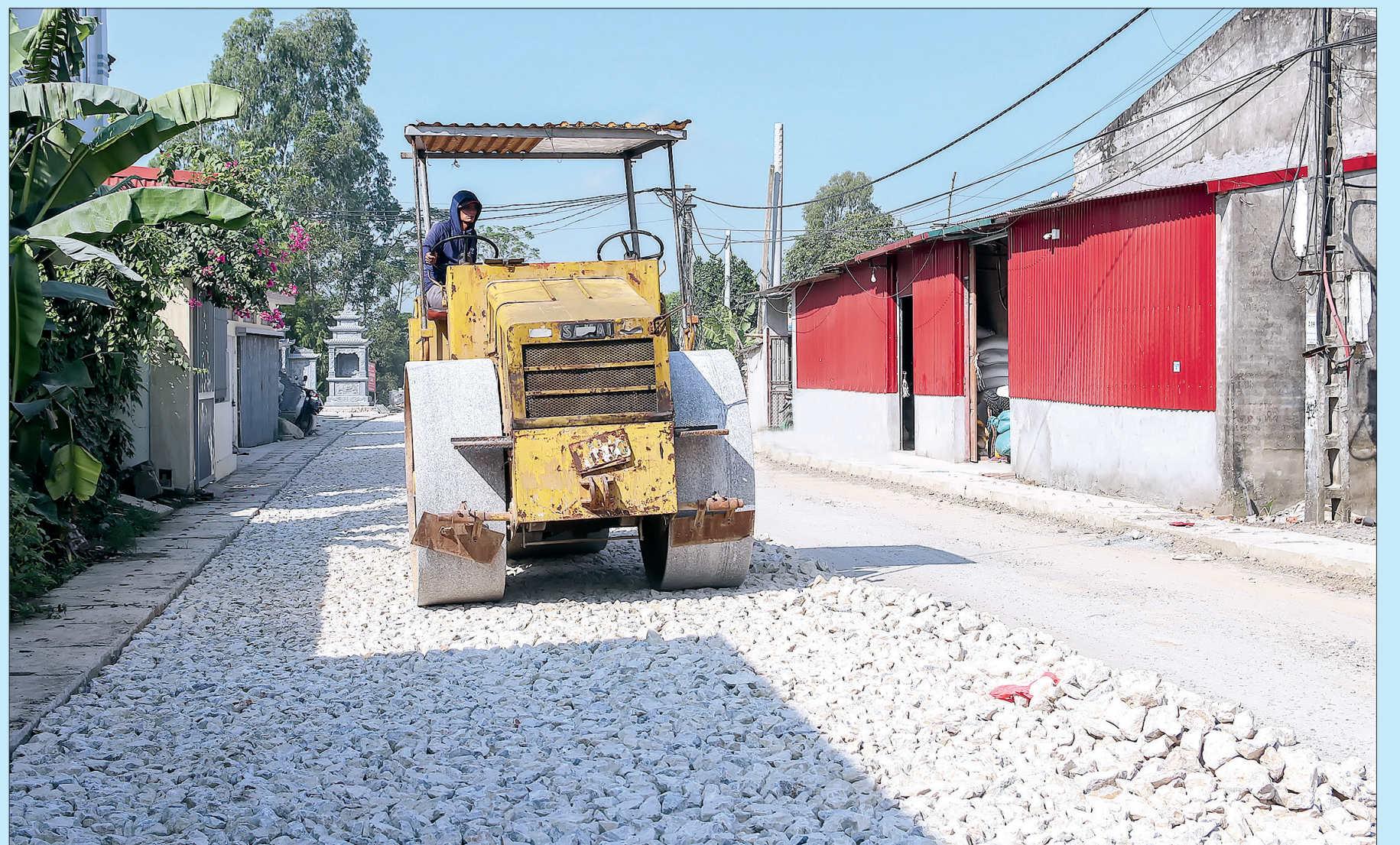
Thi công tuyến đường từ thành phố Thái Bình qua cầu Tỉnh Xuyên đến huyện Hưng Hà, đoạn từ đường ĐH.09 đến đường tỉnh ĐT.453.
