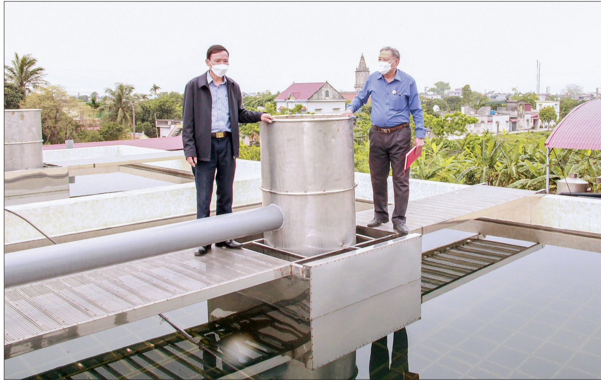
Nhà máy nước sạch Phong Châu được Công ty Đầu tư và phát triển Thành Vinh xây dựng hiện đại cung cấp đủ nước, bảo đảm chất lượng.
