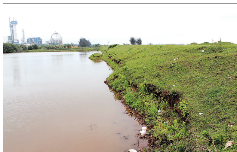
Đê cửa sông tả Trà Lý, đoạn qua địa bàn xã Thái Thọ (Thái Thụy) bị sạt lở dưới chân đê.
