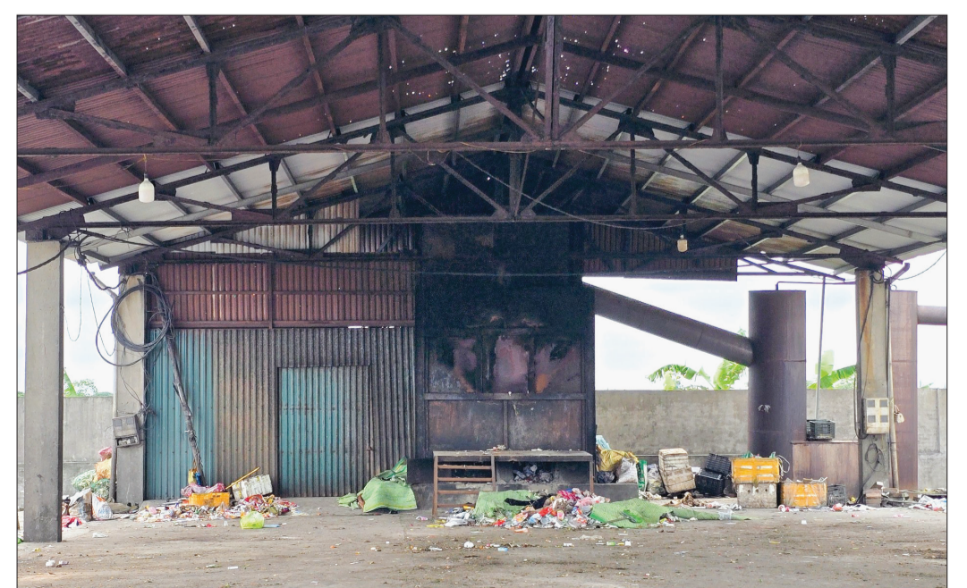
Lò đốt rác thải sinh hoạt xã Nam Trung xuống cấp.
