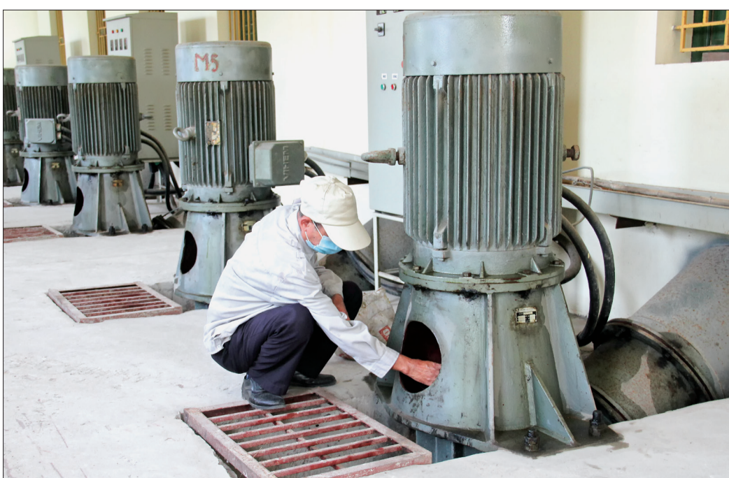
Công nhân trạm bơm Đông Tây Sơn (thành phố Thái Bình) kiểm tra, bảo dưỡng máy móc, bảo đảm vận hành an toàn phục vụ sản xuất và phòng, chống lụt bão.
