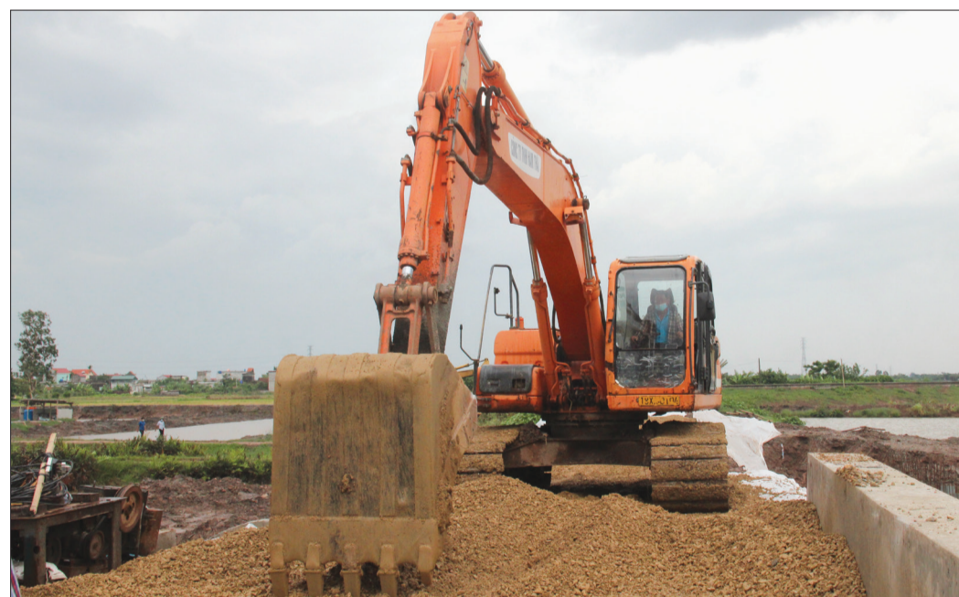
Thị công nâng cấp đê biển số 8 qua địa bàn thị trấn Diêm Điền (Thái Thụy).
