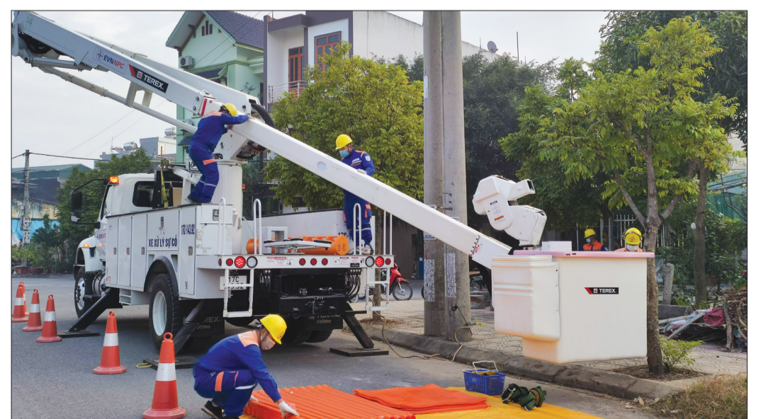
Đội Hotline, Công ty Điện lực Thái Bình kiểm tra thiết bị trước khi sửa chữa đường dây.
