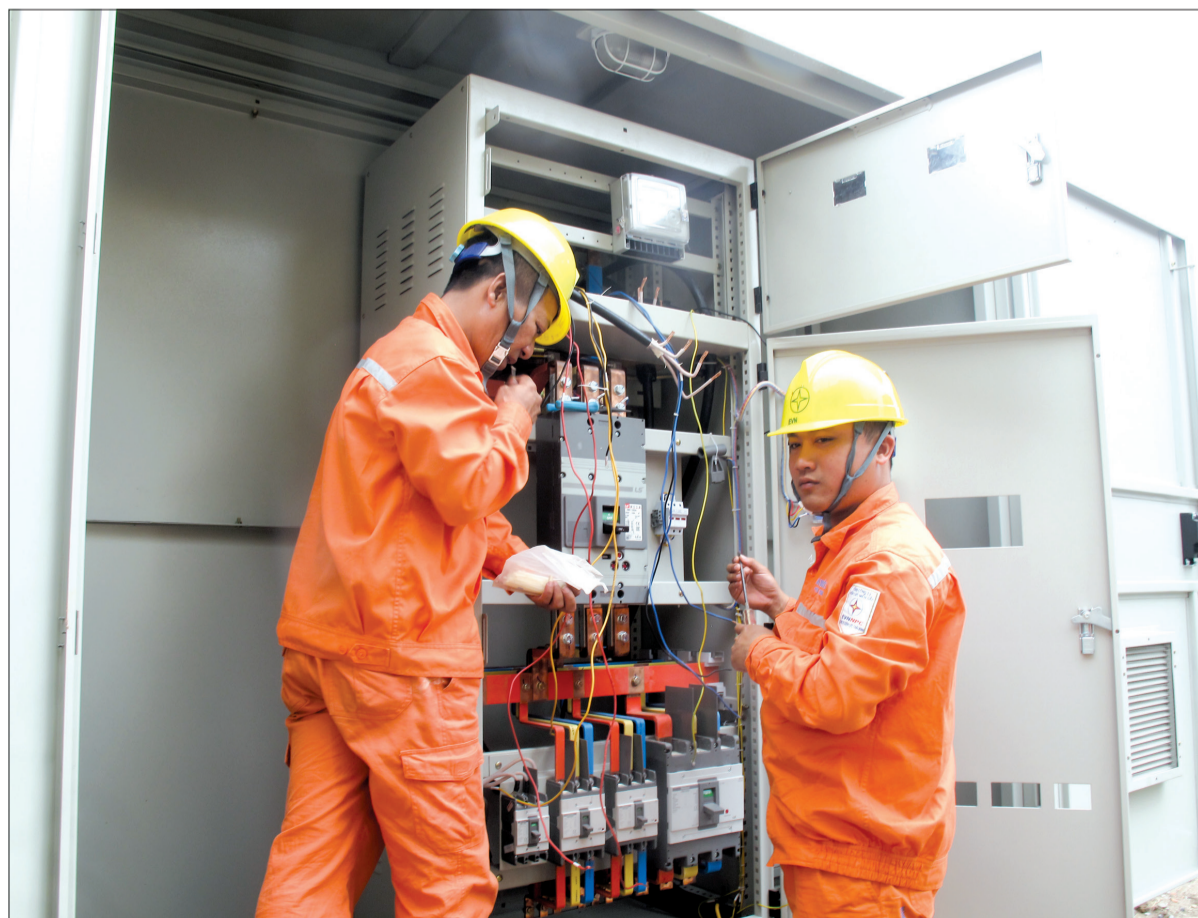
Công nhân Điện lực thành phố lắp mới trạm biến áp tại phường Quang Trung.
