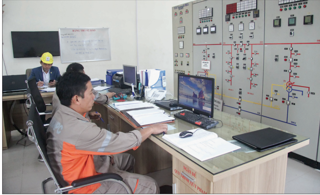
Công nhân trạm điện 110kV Công ty Điện lực Thái Bình kiểm tra vận hành lưới điện bảo đảm cấp điện an toàn, ổn định.
