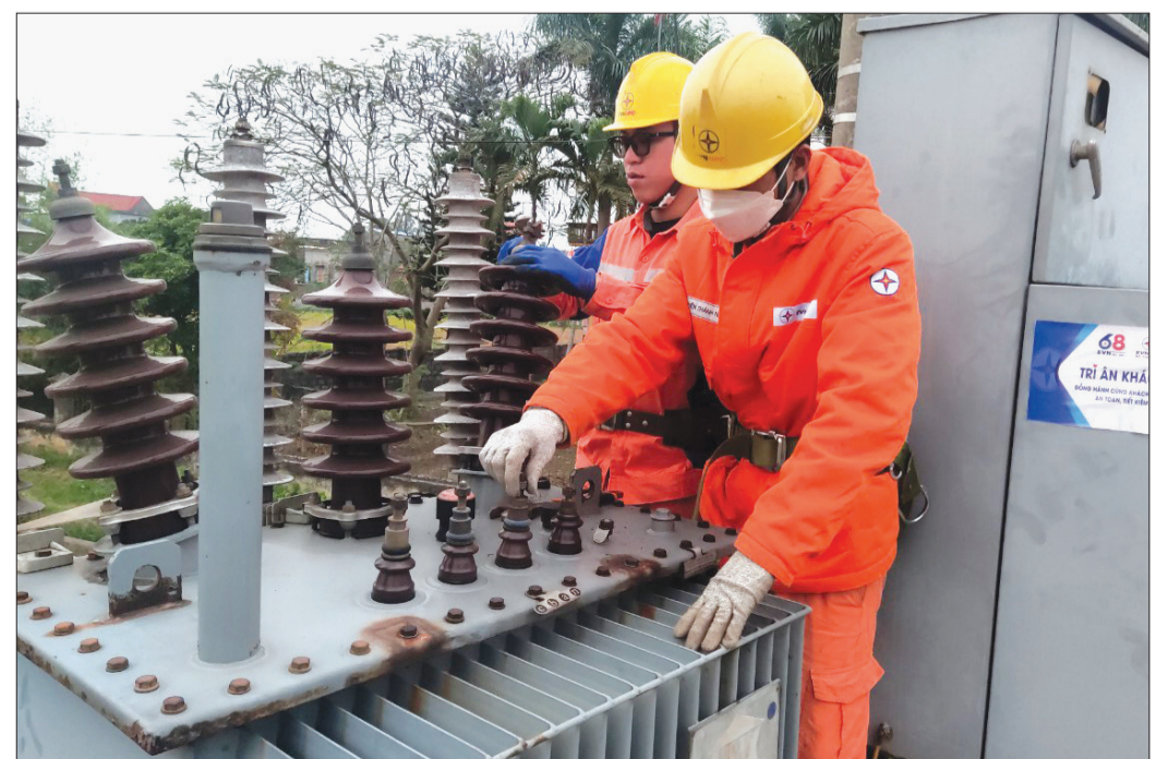
Công nhân Công ty Điện lực Thái Bình vệ sinh trạm biến áp cho khách hàng là doanh nghiệp.
