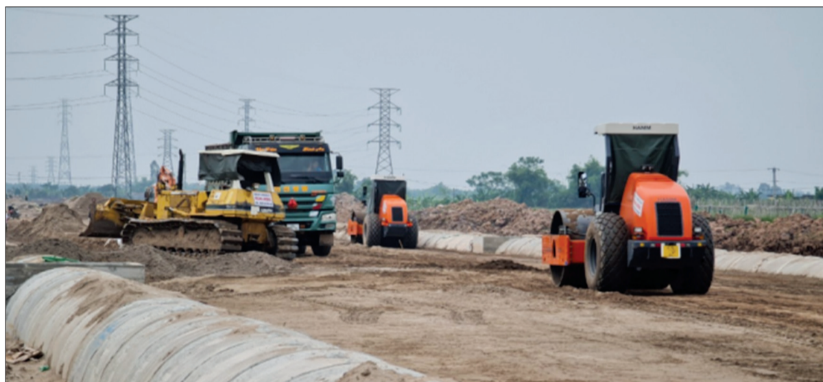
Thi công hạ tầng khu công nghiệp Liên Hà Thái trong Khu kinh tế Thái Bình.
