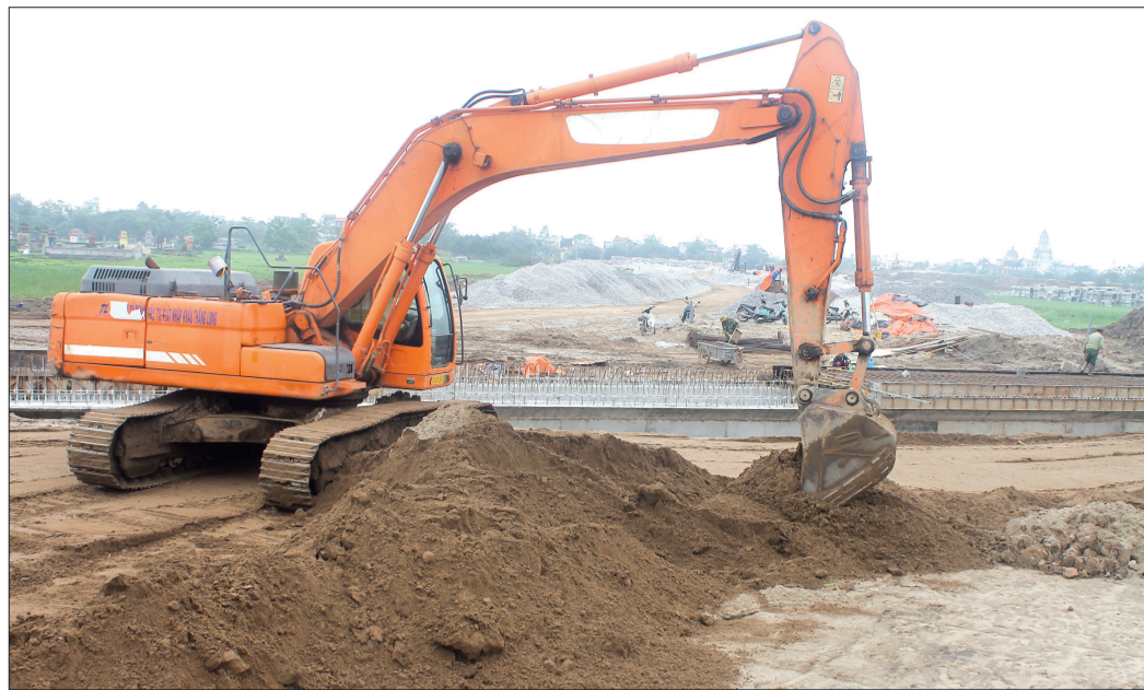
Huyện Vũ Thư đã bàn giao trên 30ha mặt bằng phục vụ thi công dự án đường vành đai phía Nam thành phố Thái Bình.
