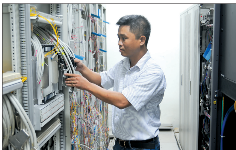
Cán bộ kỹ thuật VNPT Thái Bình bảo đảm kỹ thuật phục vụ công tác chuyển đổi mã vùng.
